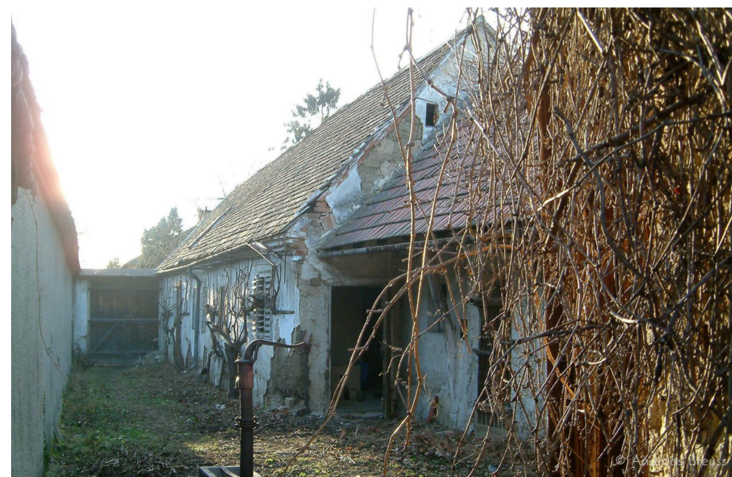
Lehmhaus erbaut 1850, Zustand nach 35 Jahre Leerstand (2004)
